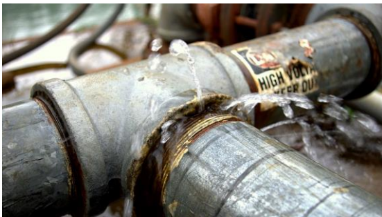
Loši spojevi cevi
