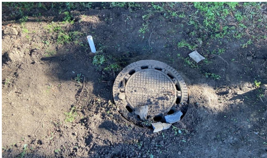
Слика 4.3.7 Антена извучена на површину терена и заштићена помоћу беле пластичне цеви
