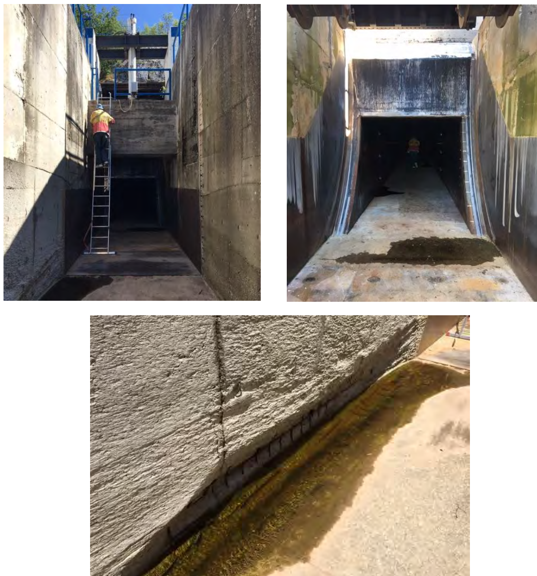
Slika 6.7 Izlazna građevina derivacionog tunela Fatničko polje – Bilećka akumulacija: Gore levo) Pogled iz brzotoka na zatvaračnicu; Gore desno) Pogled na suženi izlaz iz tunela; Dole) Oštećenje zida brzotoka usled pojave kavitacije.
