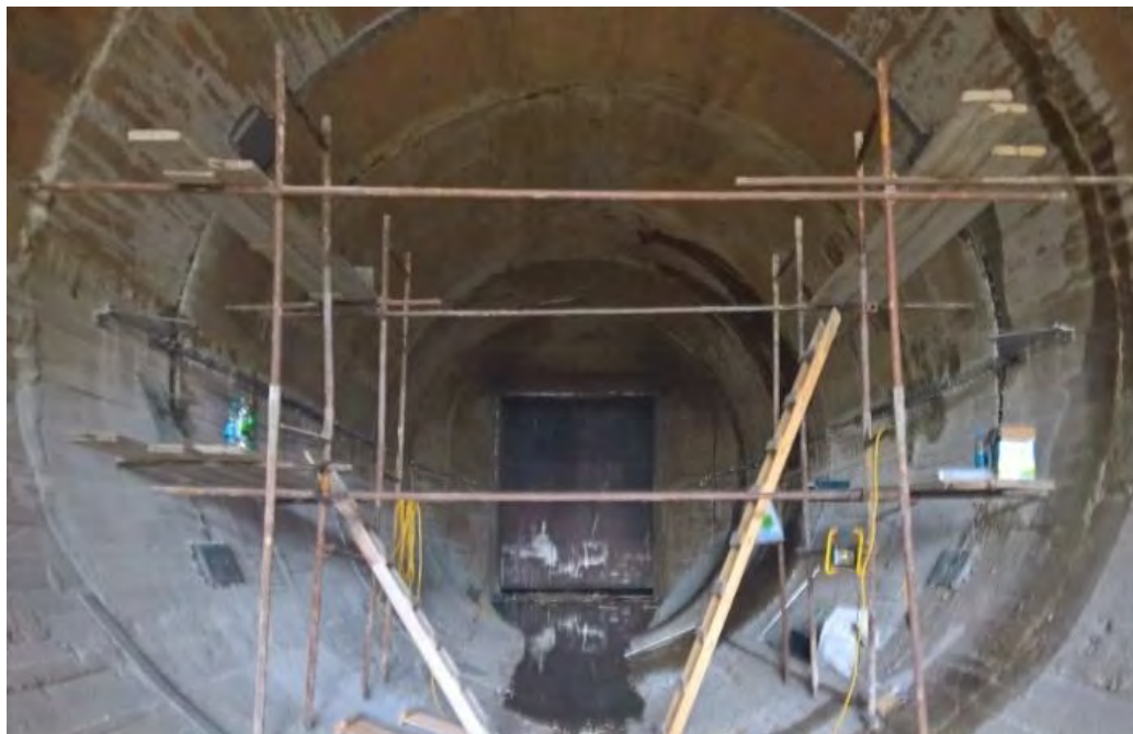
Slika 6.13 Detalji izvedenog mernog mesta Pađeni u neposrednoj blizini ulazne građevine tunela FP – BA u Fatničkom polju: Levo) Podsystem Large Flat DC-2 EM senzor (EM-B1 i EM-B2) i EM senzor brzine u toku „Ajkulino Krilo“ (EM kontrolna – B), Desno) Merno mesto tokom montaže.
