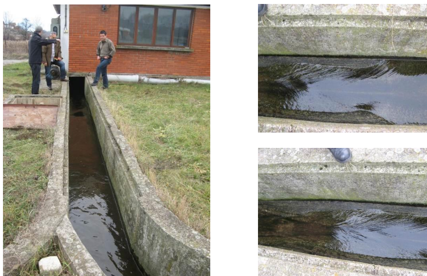
Slika 3.1.2. Odvodni kanal iz postrojenja za prečišćavanje vode sa mernim suženjem u PPOV JKP Bukulja Aranđelovac
