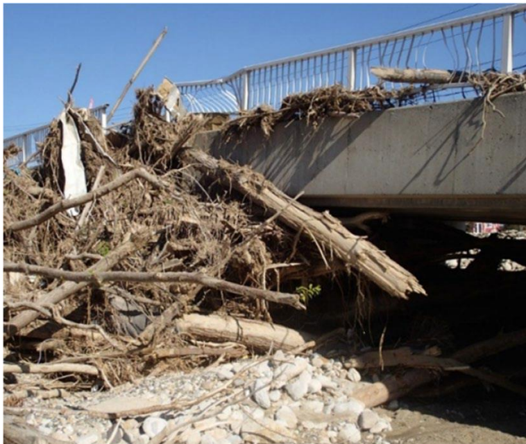
Slika 1 : Kolizija plivajućeg nanosa drvene strukture sa mostovskom konstrukcijom
