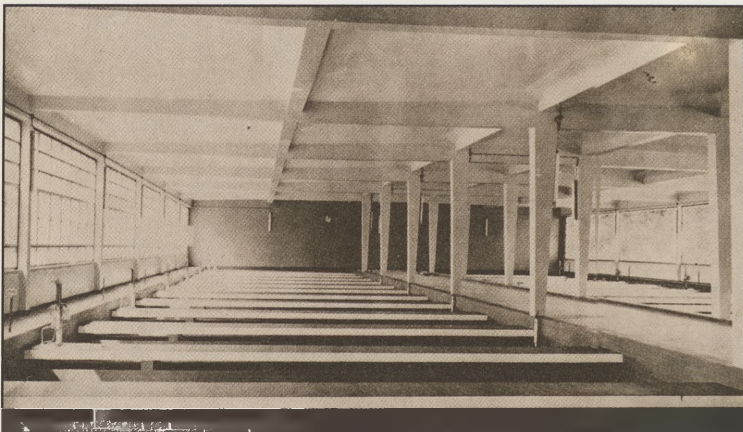
Слика 13 – Постојење за пречишћавање воде „Баново брдо“ у Београду – филтерско постројење
