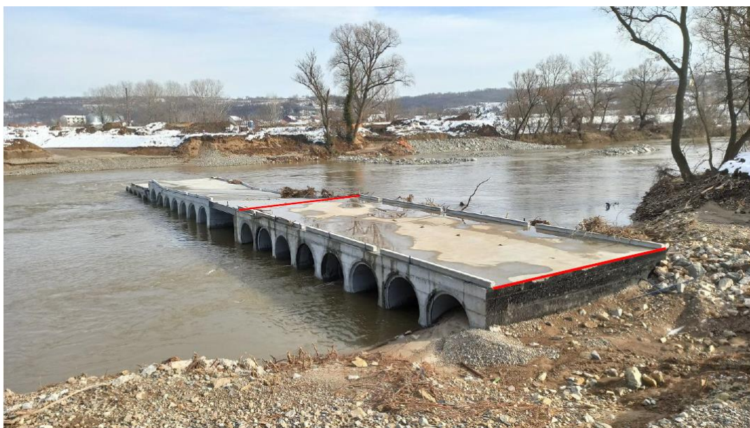
Slika 4. Oštećen objekat, pogled sa leve obale; srednji deo i ploča preko ribljeg prelaza deformisani do neupotrebljivosti, na levoobalnom delu objekta se ne zapažaju oštećenja
